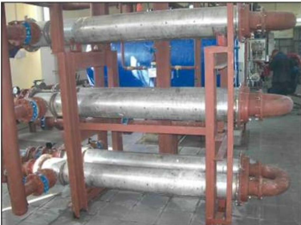
Рисунок 8. Теплообменники ВВПИ в котельной МУП «Теплосервис»
